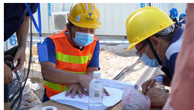
▲ 2021年9月17日，福建省漳州市台商投资区启动方舱隔离点建设，漳州分公司第一时间对接台商投资区管委会，了解隔离点各项网络保障需求，制定光缆布放和室内宽带安装方案。截至2021年9月22日凌晨，方舱隔离点光缆全部布放到位，首批115个方舱宽带已交付使用，第一批定点医院隔离人员顺利入住
